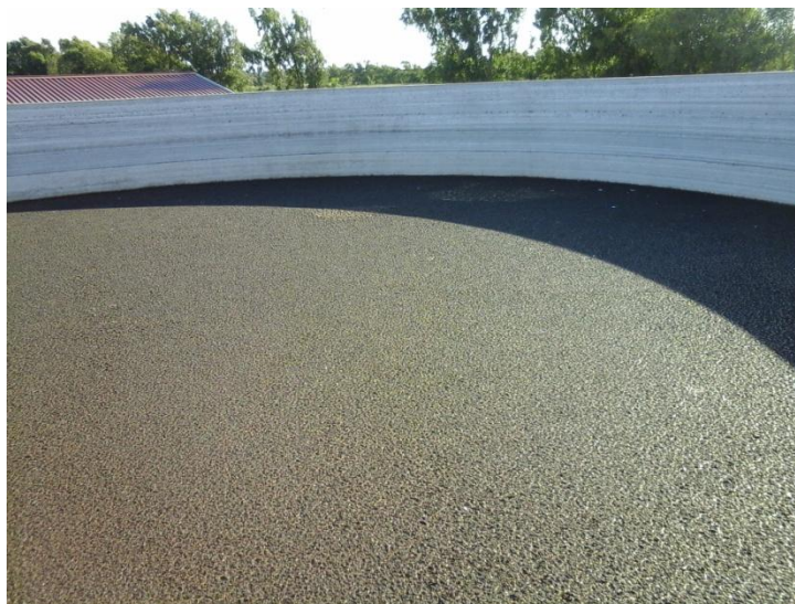
Figura 35. Interno di un vascone di liquame.
